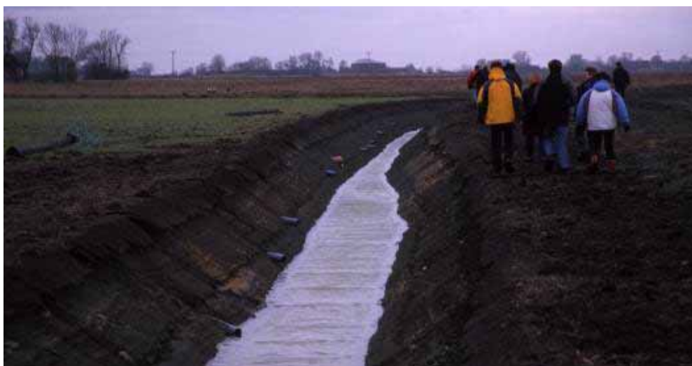
Täckdikningsrör som mynnar i ett väl rensat dike.
